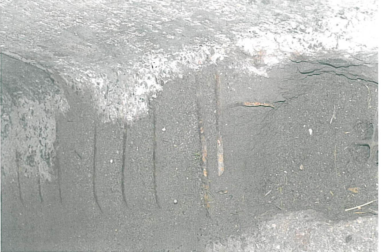
15. Armături vizibile la borduri și gură de scurgere înfundată
