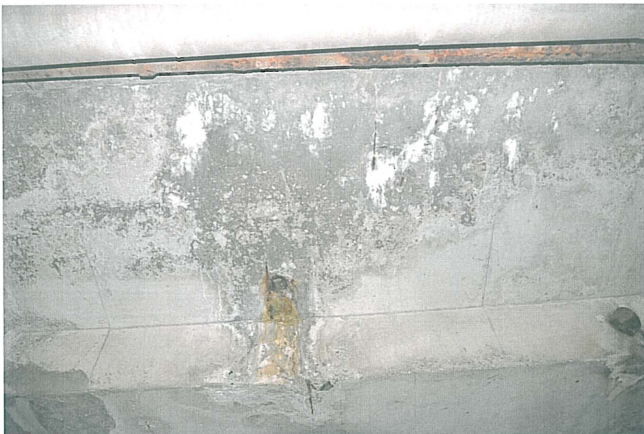
11. Consola de trotuar la partea inferioară cu infiltrații și carbonatări
