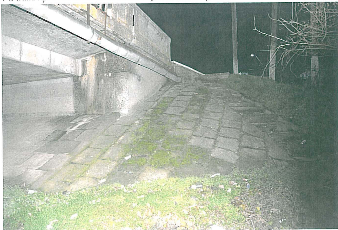
14. Infiltrații în zona rostului între suprastructură și culee
