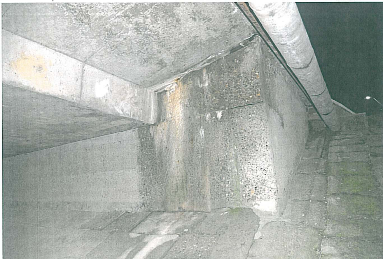
12. Infiltrații în zona rostului între suprastructură și culee
